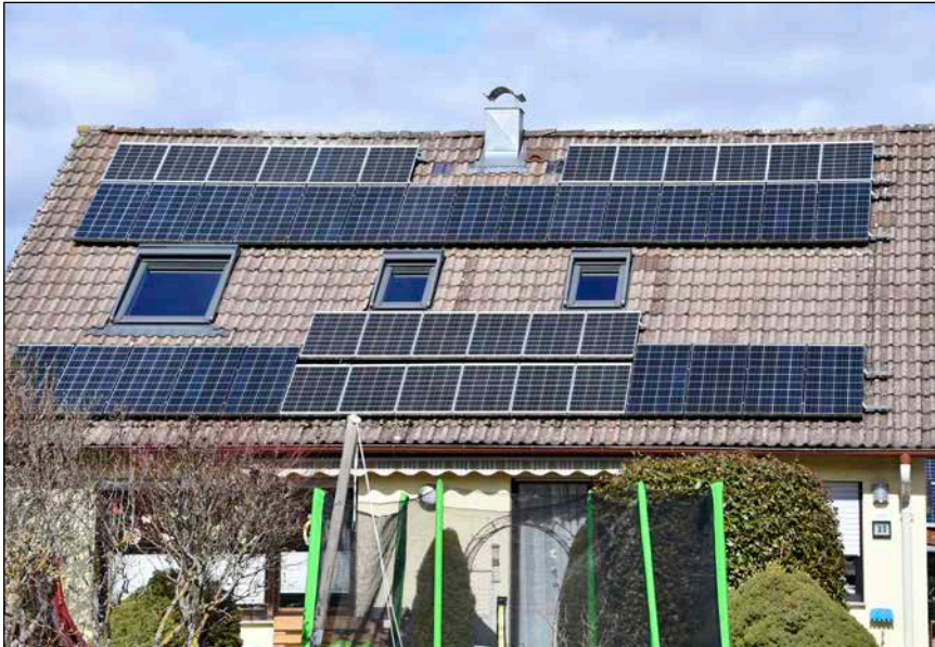
Bild 1: Schon seit 22 Jahren arbeitet diese PV-Anlage in Pforzheim (Baden-Württemberg)
