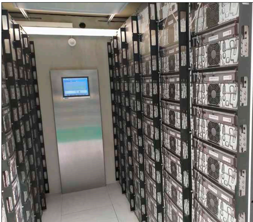
Bild 2: Große Stromspeicher (hier ein Blick in einen Speichercontainer mit vielen einzelnen Batterieeinheiten) können auch Stabilität für das Stromsystem bieten.
