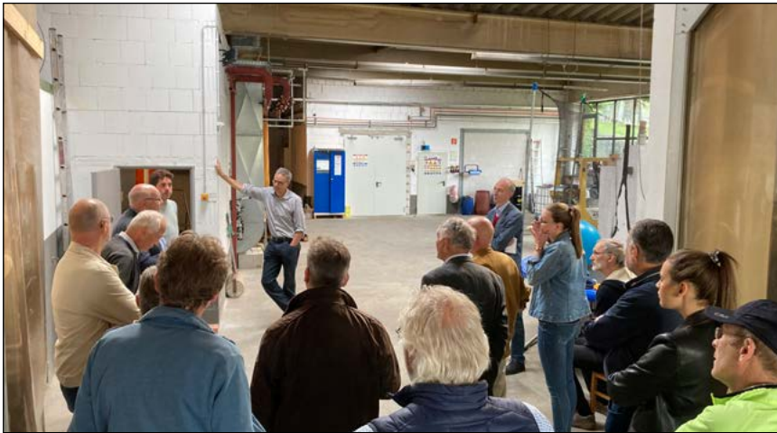
Bild 1: In der Nahwärmezentrale Altenmellrich
