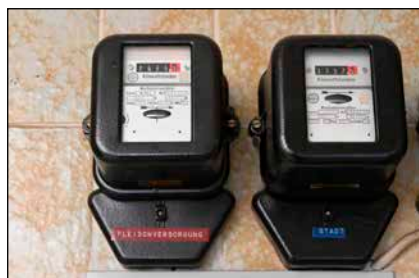
Bild 3: Immer wieder Kern von Diskussionen mit dem Netzbetreiber bei der Ü20-Umrüstung: Die vorhandene, teils veraltete Zähleranlage
