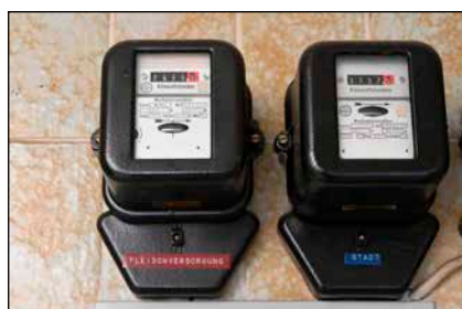
Bild 3: Immer wieder Kern von Diskussionen mit dem Netzbetreiber bei der Ü20-Umrüstung: Die vorhandene, teils veraltete Zähleranlage
