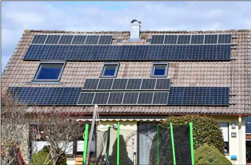
Bild 1: Ausgeförderte Ü20-PV-Anlage in Pforzheim
