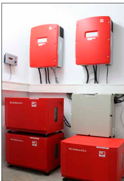
Bild 3: Dreiteilige Speichereinheit mit 19,5 kWh Bruttokapazität auf einem Schweinemastbetrieb; oben die Wechselrichter, unten die drei Lithium-Ionen-Batteriespeicher und die Back-up-Box für die Notstromversorgung
