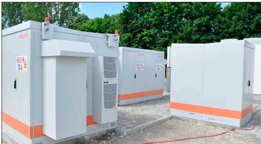
Bild 2: Installation eines Outdoor-Speichers bei der Molkerei Zott in Günzburg
