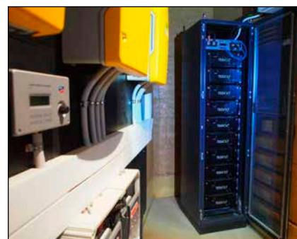
Bild 4: Installation eines 48-kWh-Gewerbespeichers mit Lithium-Ionen-Technik des Herstellers Tesvolt
