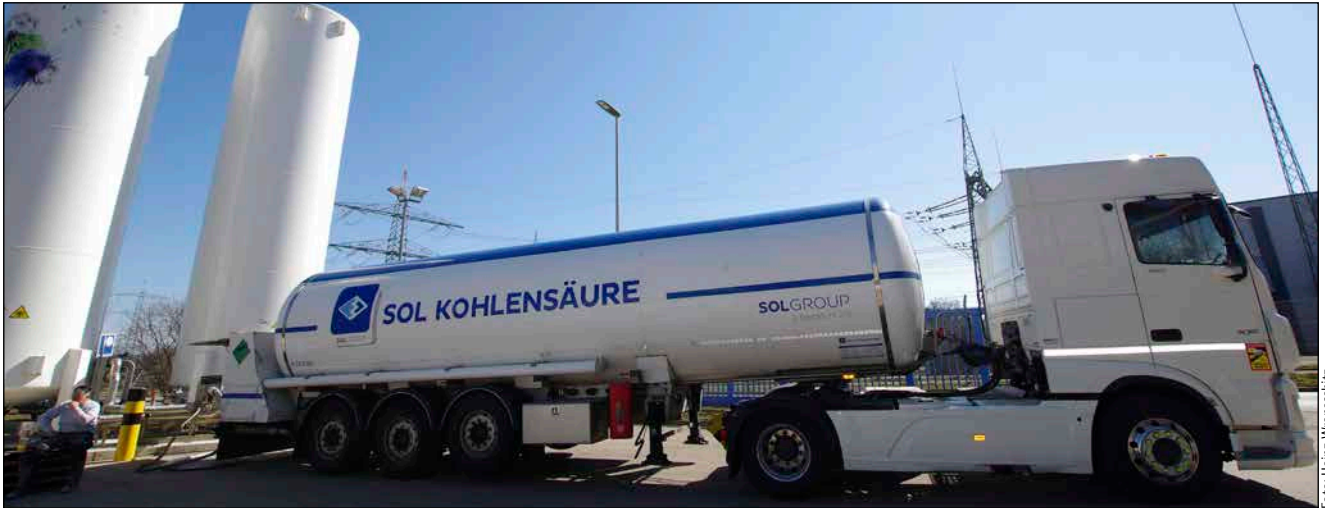
Bild 1: Lkw-Befüllanlage, links die CO 2 -Speicher.
