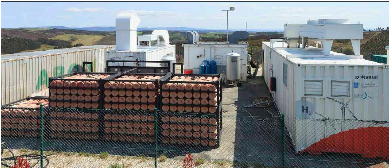
Bild 2: Demonstrations-Power-to-Gas-Anlage in einem spanischen Windpark
