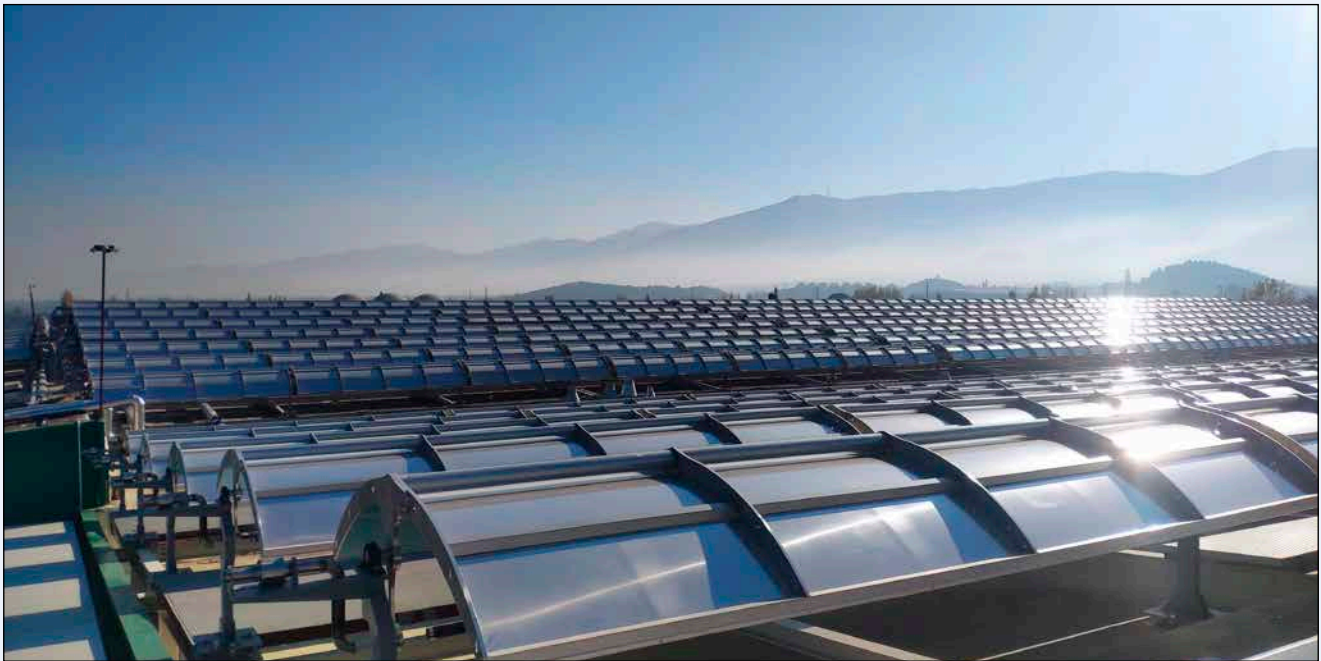
Bild 1: 4.500 m 2 solarthermische Anlage in Izmir für einen Verpackungshersteller
