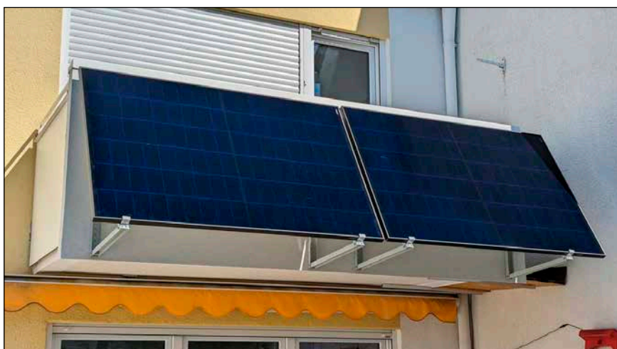
Bild 5: Das Anker Solix wurde inklusive Aufständerung direkt an die gemauerte Balkonbrüstung geschraubt.
