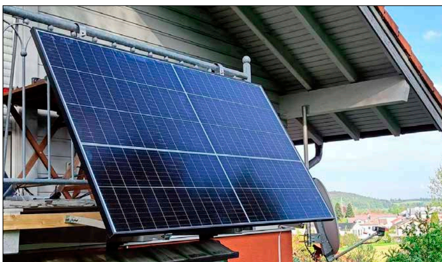
Bild 4: Die Panels dieses Balkonkraftwerks sind an einem runden Balkongeländer eingehängt.
