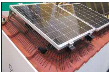
BirdBlocker am Modulrahmen
