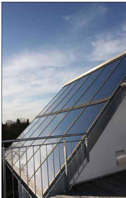
Bild 1: Flachkollektoren auf einem Hausdach in München
