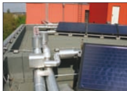
Bild 5: Solardach in der Swinemünder Straße, Berlin (DEGEWO)
