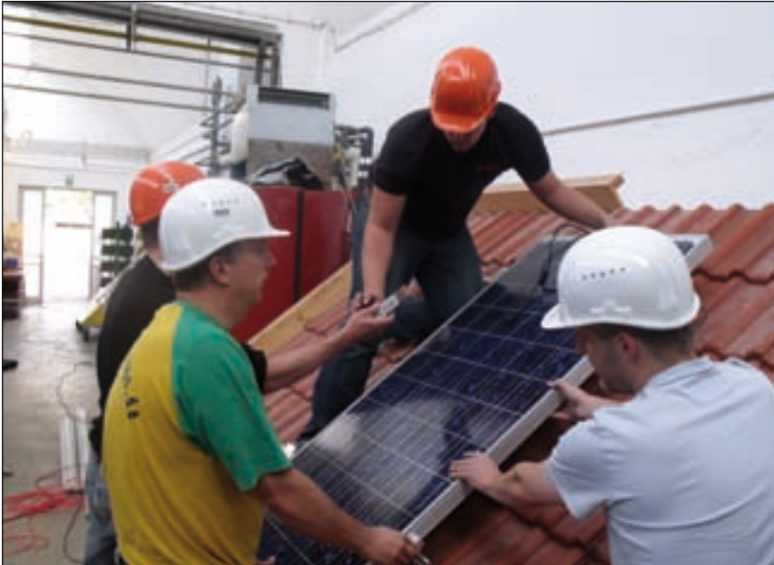
Bild 1: DGS-Solarschule Nürnberg: Unter Anleitung von Solarexperte Oskar Wolf wird ein Solarmodul montiert.
