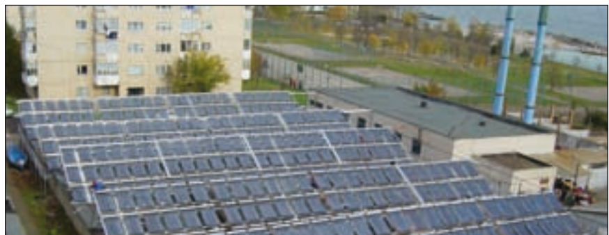
Bild 3: Nahwärmeversorgung in Mangalia, Kreis Constanta – 360 Vakuumröhrenkollektoren, die ca. 210 MWh/Jahr produzieren und damit ca. 70% des Wärmebedarfs übernehmen können, Baujahr 2005
