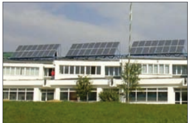
Bild 5: Die 10 kWp netzgekoppelte PV-Anlage auf dem Dach der Transilvania-Universität in Brasov (Kronstadt), Baujahr 2007
