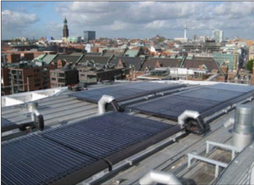
Bild 1: Solarthermische Anlage aus dem Monitoring in der Hafencity
