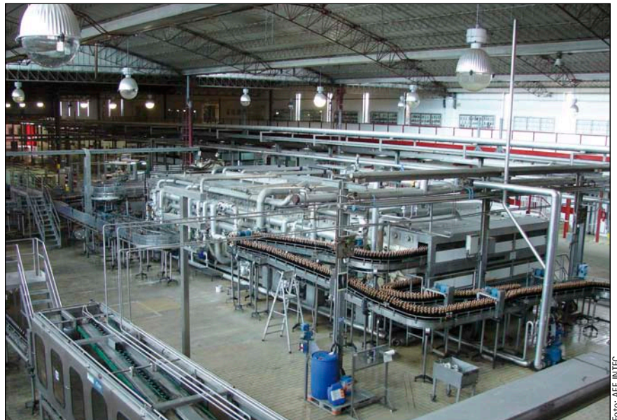
Bild 4: Die abgefüllten und verschlossenen Flaschen werden im Tunnelpasteur bei 60 bis 70°C keimfrei gemacht. Ein zusätzlicher Wärmetauscher wird dafür sorgen, dass sich die Solarwärme besser in die Anlage in Valencia integrieren lässt.
