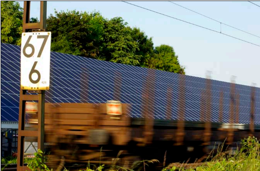
Bild 1: Als Lärmschutzwand entsteht eine 1,2-Megawatt-PV-Anlage neben der Bahnstrecke Nürnberg-Regensburg: Die Stadt Neumarkt finanziert neben der Siedlung „Bühl“ im Ortsteil Pölling das System selbst, um die Bevölkerung besser vor Lärm zu schützen
