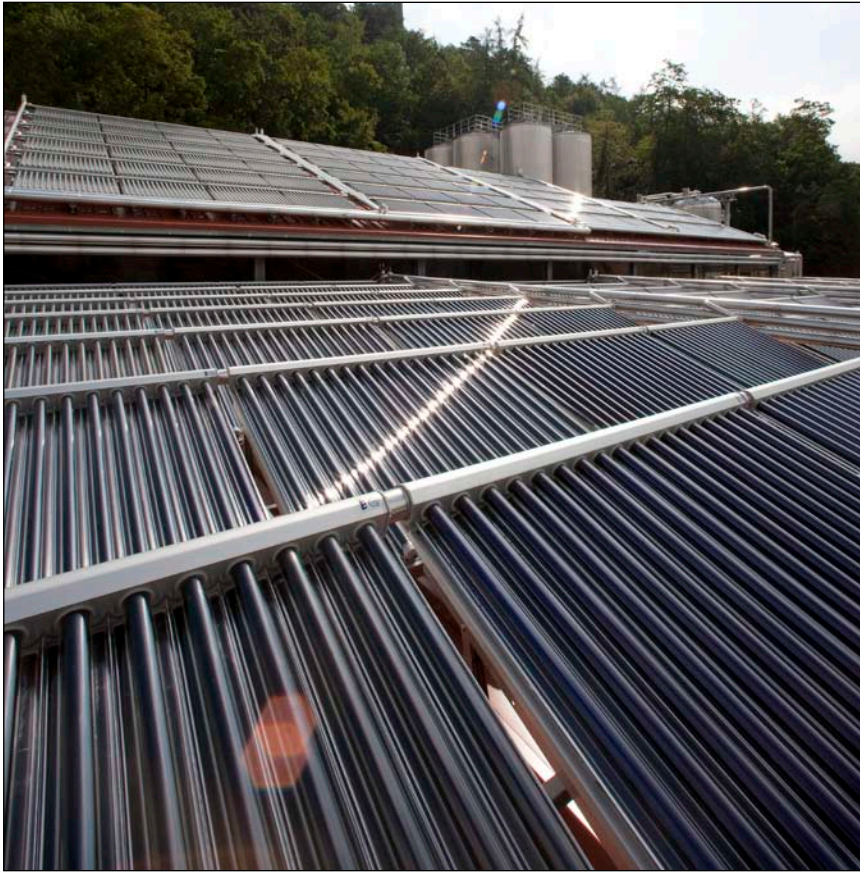
Bild 1: Konzentrierende Vakuumröhrenkollektoren zur Unterstützung der Brauprozesse
