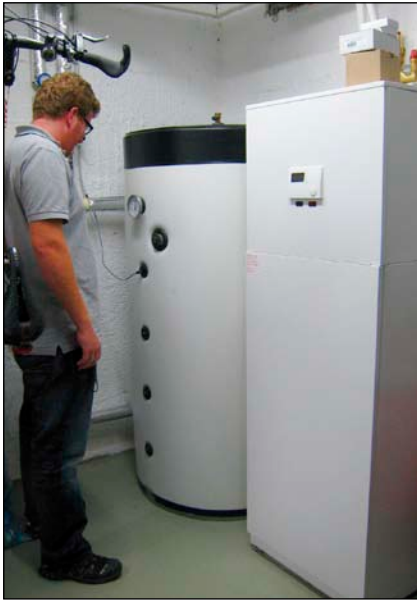
Erdsonden-Wärmepumpe und Warmwasserspeicher
