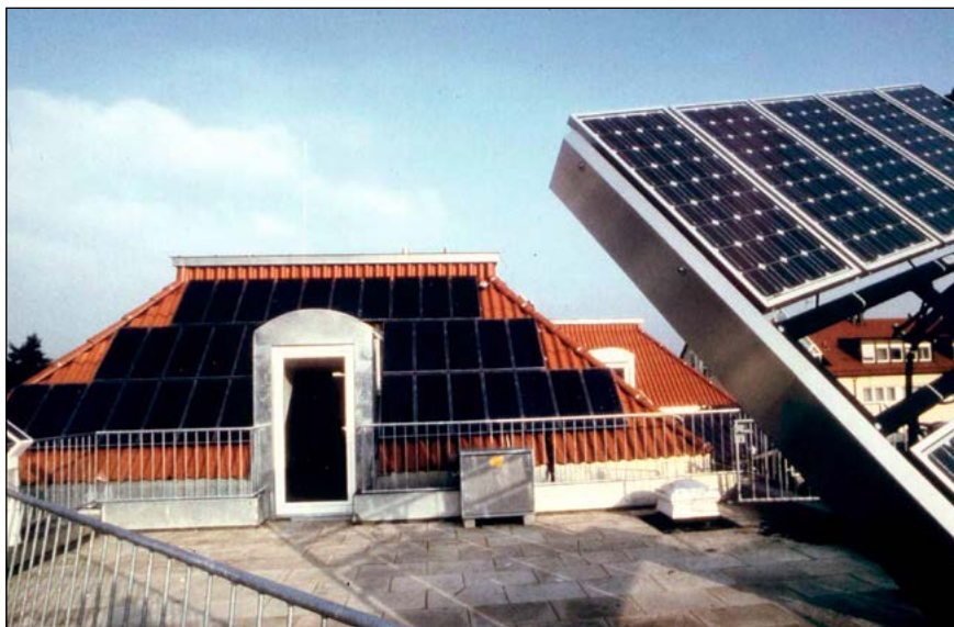
Bild 1: Ob solche Solarmodule aus dem Jahr 1990 heute noch als Ersatzteile erhältlich sind, ist fraglich. Vorne Siemens, hinten AEG
