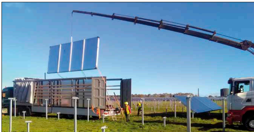
Bild 2: 16 m 2 große freitragende Kollektoren brauchen wenig Stützen
